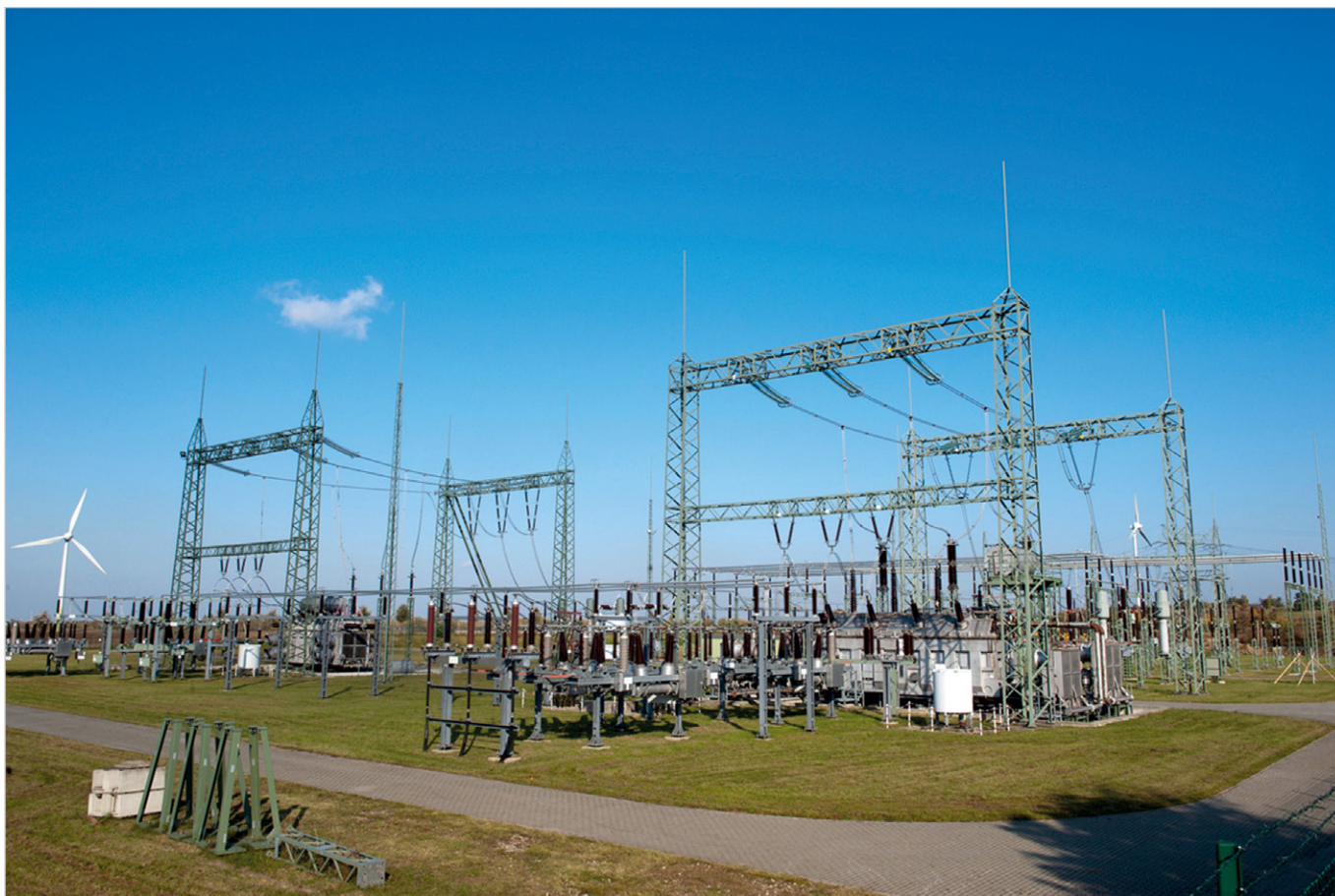
Umspannwerk Bertikow in der Uckermark (Brandenburg)
